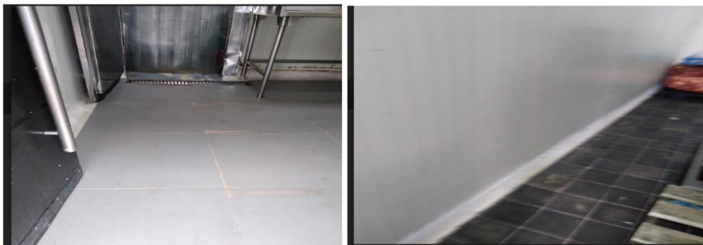
Fotografías No.2 Se evidencia el mal estado de pisos, mediacañas, paneles divisorios y equipos que son necesarios modificar enfocados en la normatividad vigente para Cuartos Fríos
