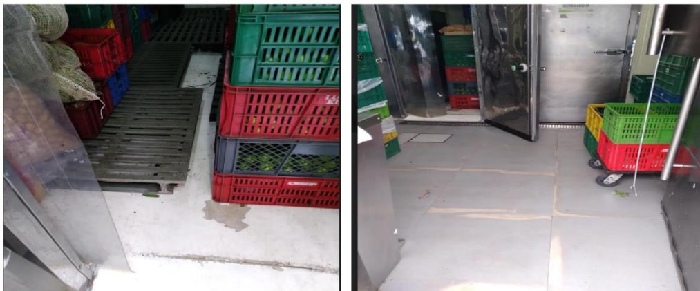
Fotografías No.3 Vetustez considerable en los cuartos fríos existentes.
